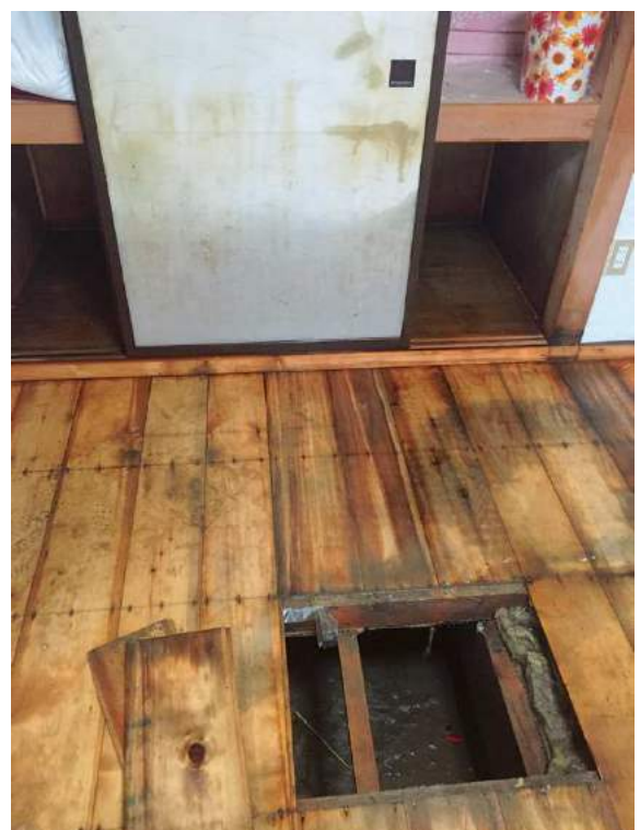
室内の被害状況も撮っておく
