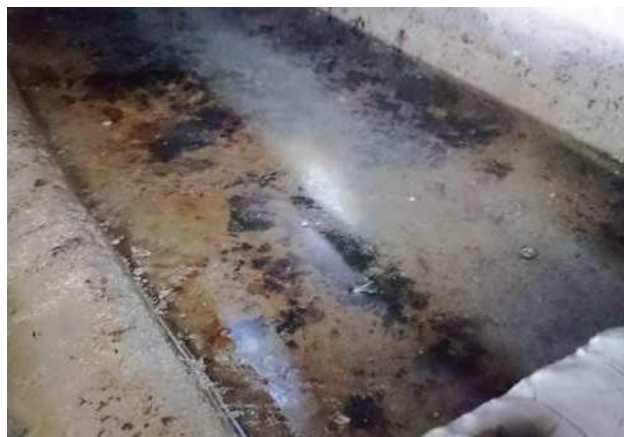
水が残って悪臭が発生する
