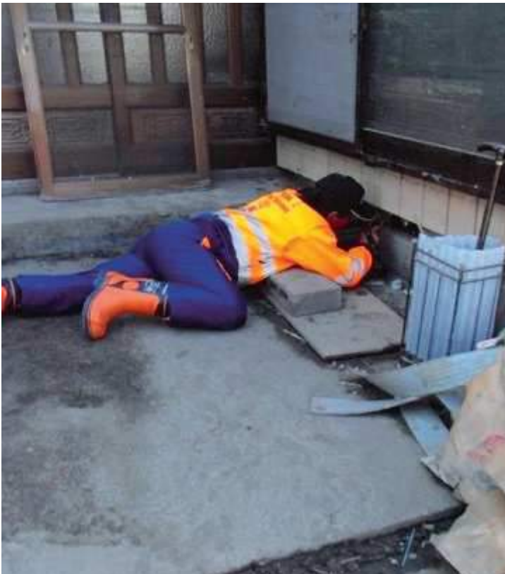
通風口から床下の泥を確認する
