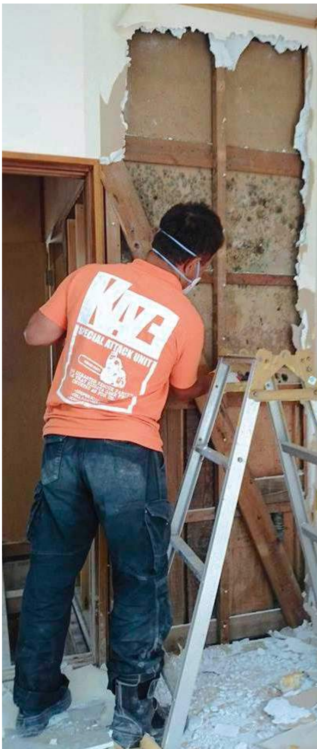
壁をはがすとカビが生えている
