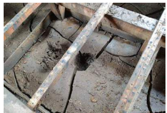
床下にたまった泥（写真③）
